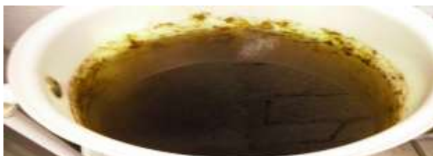
Expansionskärlet efter att systemet fyllts upp efter vattenläckan 2014.
